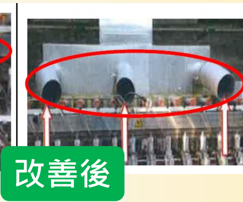
增設局部排氣口
