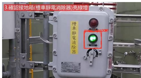
3. 確認接地箱(槽車靜電消除器)亮綠燈
